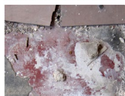
Dalle de sol souple sur béton peint rouge // à curer
