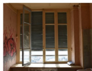
Fenêtre en bois // à curer Allège tablette en bois // à restaurer
