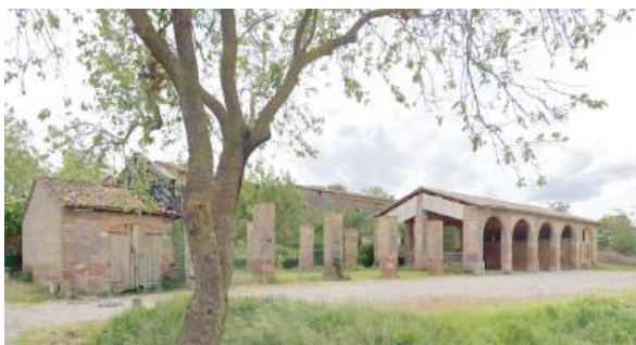
Avant : Réfection de la toiture d'une partie du hangar, l'autre partie est en ruines
