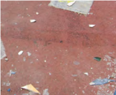
Etanchéité - bitume élastomère // à curer
