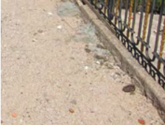
Dalle de béton avec gravier // à curer
